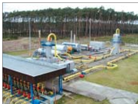
Obr. 2: Nadzemná časť technológie podzemných zásobníkov, podľa [4]
